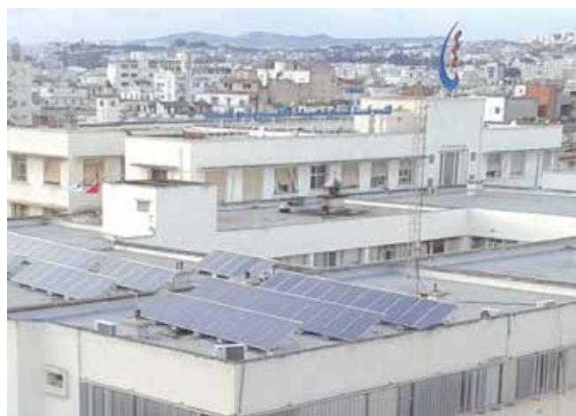
Panneaux photovoltaïques sur le toit du Siège de la STEG
