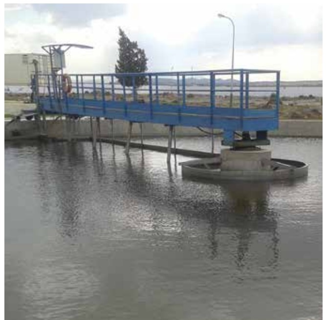
Décanteur de la station d'épuration des eaux à Hammamet
